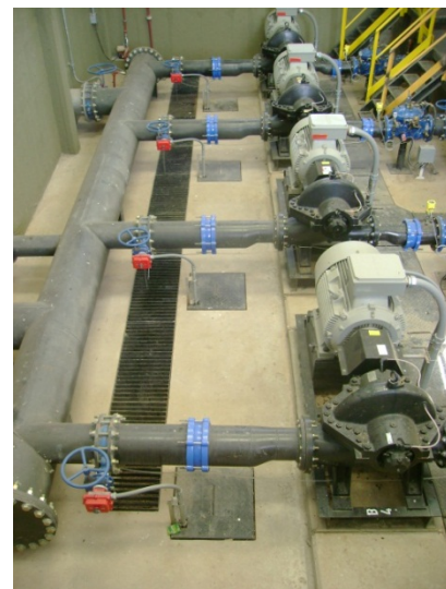
Figura 3. -Foto Estación De Bombeo Acueducto Centro
